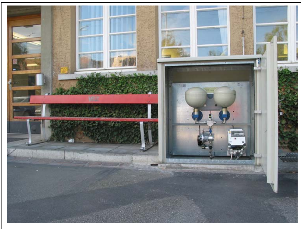
Standard Anlage (2 Behälter) Schrankausführung. Wird bei wenig befahrenen Strecken eingesetzt, z. B. in Depots
